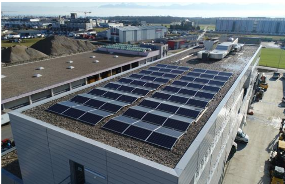
Installation photovoltaïque SEIC sur le toit du bâtiment administratif de Perrin Frères à Gland (VD)
